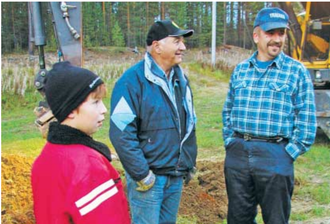
■ Såväl unga som äldre deltog i arbete med att dra fram fiber i Tannsele.
